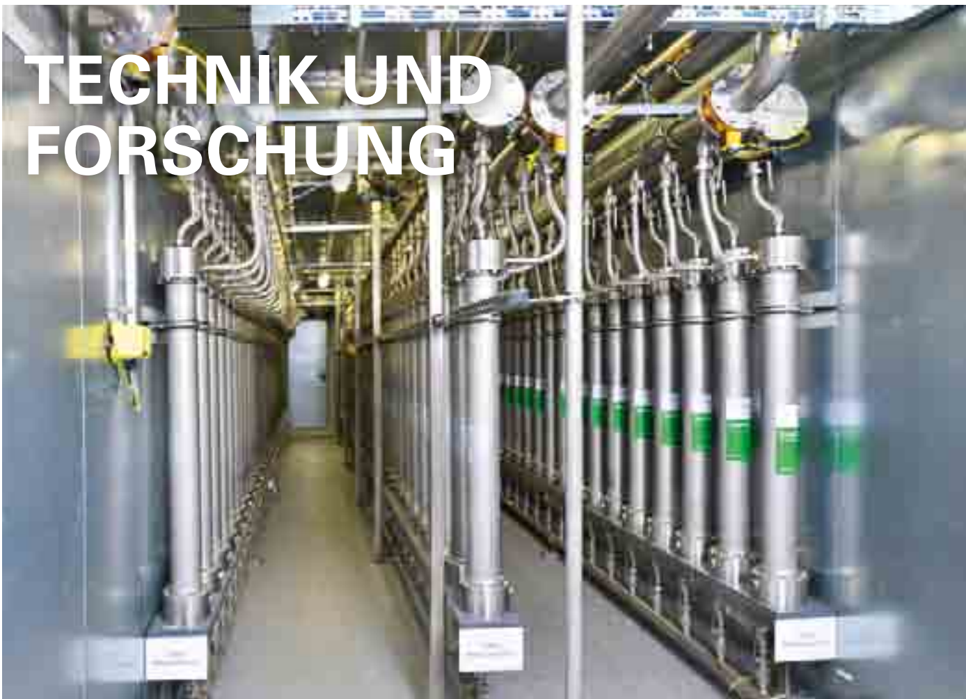
Sowohl im sachsen-anhaltinischen Sachsendorf als auch im nahe gelegenen Köckte kann der Methangehalt mittels Nutzung der hochselektiven Membranmodule auf über 97 Prozent gesteigert werden (hier die stehende Variante).
